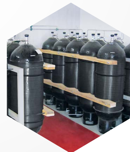
Баллоны для систем пожаротушения
